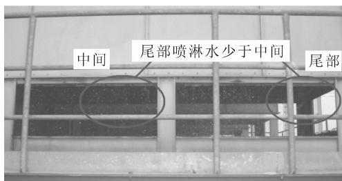
图 8 改造前冷却塔喷水情况
